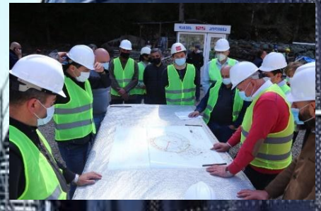
წყლის გაწმენდის სისტემის მშენებლობა აბასთუმანში, საქართველო (2021 წ. აპრილი) (წყარო: შპს „საქართველოს გაერთიანებული წყალმომარაგების კომპანიის Facebook გვერდი).
