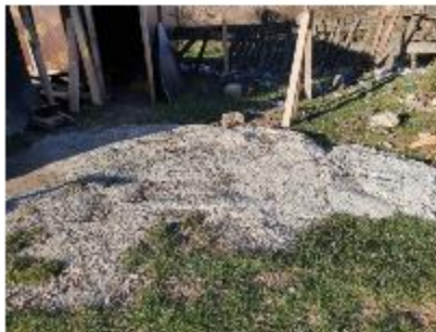
ფოტო #10: სამშენებლო მოედანზე ნიადაგზე დაღვრილი ბეტონი
