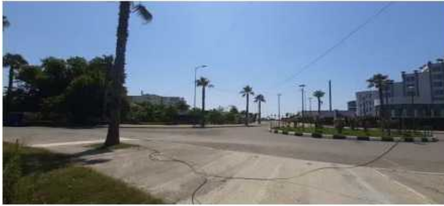
ახალი კანალიზაციის მილის მოწყობა (დ160მმ, სიგრძე 206 მ) ფოლადის ფარცმის მილით (დ325მმ/6მმ, სიგრძე 6მ)
